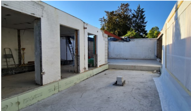
Baujahr 1966 Zielsanierung: EH 85 EE (Wärmepumpe)
